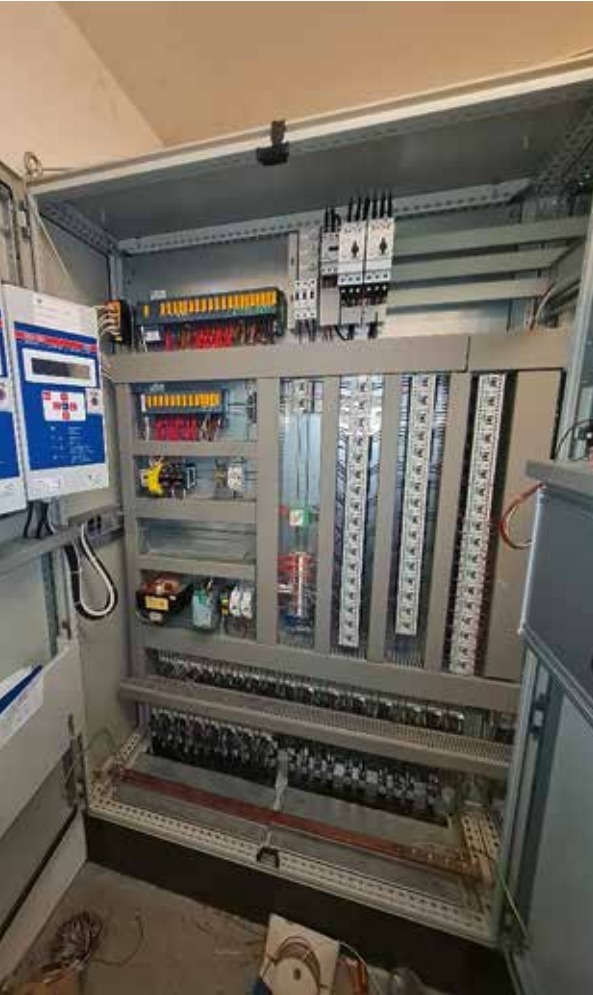
SCHALTSCHRANK NACH RETROFIT mit neuen Wöhwa-Wägeterminals GCU50+ Profinet und neue SPS-Siemens S7-1500 ET200 SP und Anbindung Via Ethernet/Profinet. Foto: Wöhwa
