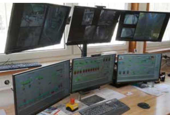
KOMMANDOZENTRALE: die neue Anlagensteuerung.
