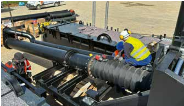
DAS PUMPENPONTON beherbergt die Pumpe trocken und sicher.
